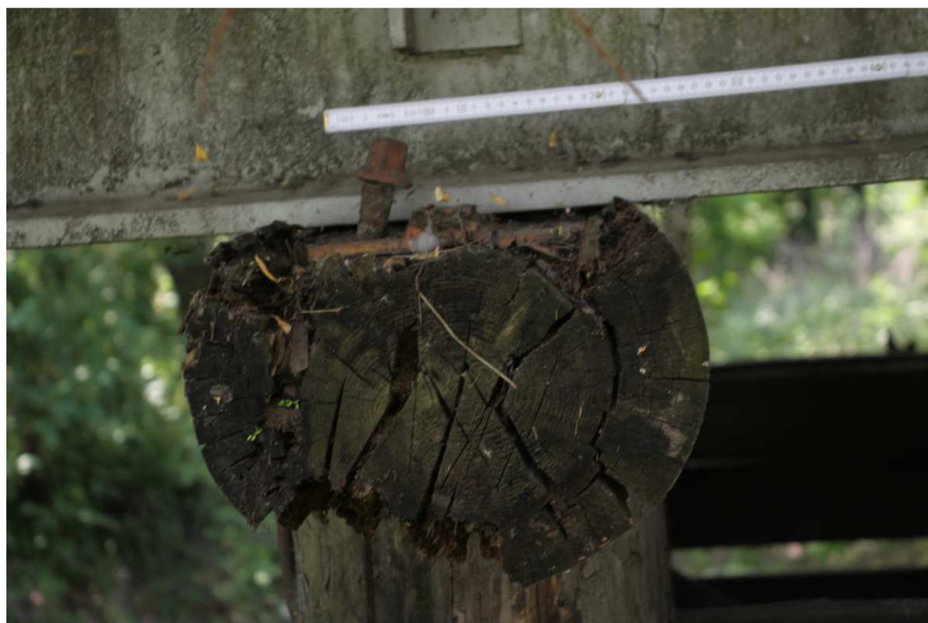
Rys. 4.9. Ubytki przekroju belek poprzecznych podparcia
