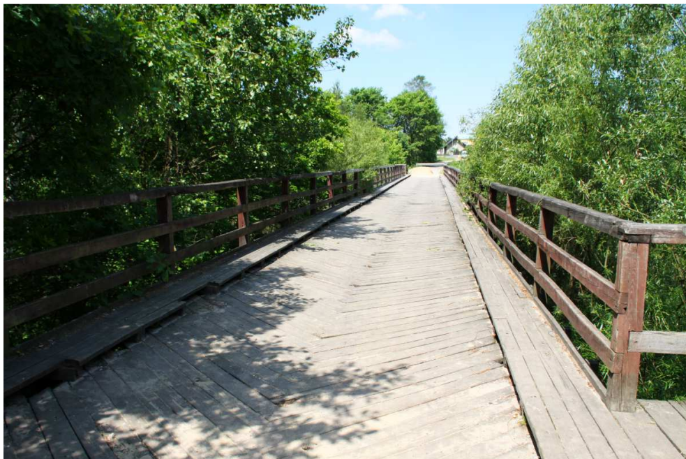
Rys. 4.6. Ubytki w elementach nawierzchni
