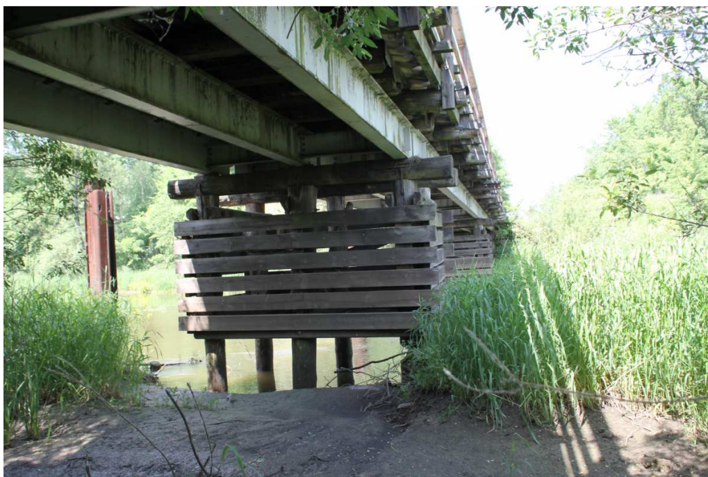
Rys. 4.10. Podpora nurtowa. Widoczne zagnicia palcusłupów
