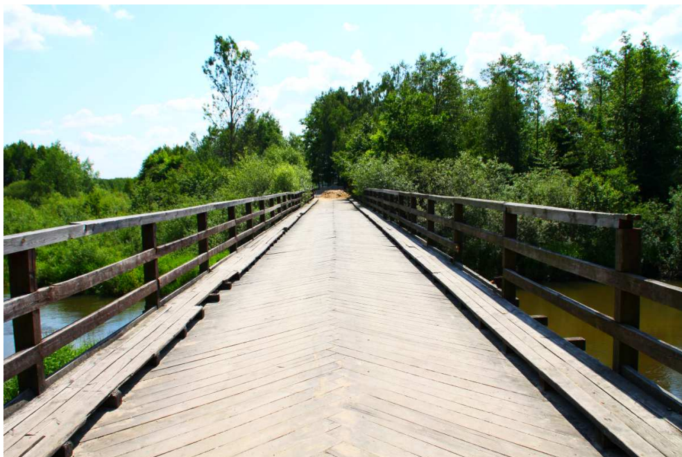
Rys. 4.2. Widok ogólny na pokład drewniany. Widoczne uszkodzenia elementów wyposażenia. Ubytki elementów balustrad, opasek chodnikowych i pokładu jezdnego
