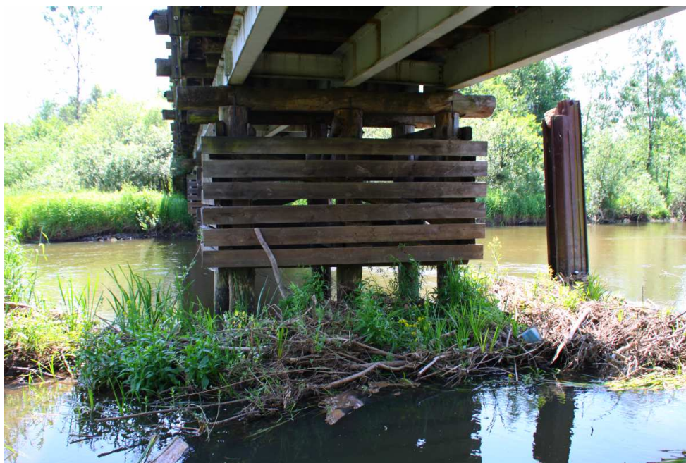
Rys. 4.4. Widok na podporę nurtową. Znaczna degradacja biologiczna podpór słupowych na poziomie wody
