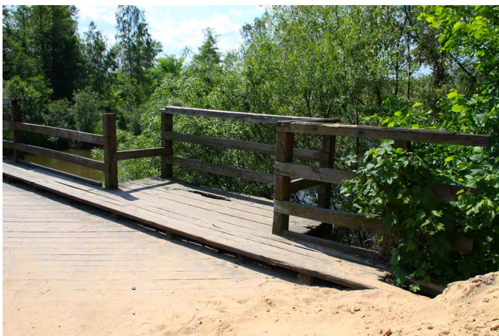
Rys. 4.3. Ubytki wyposażenia na wsporniku przeciwpożarowym od strony m. Krzętów
