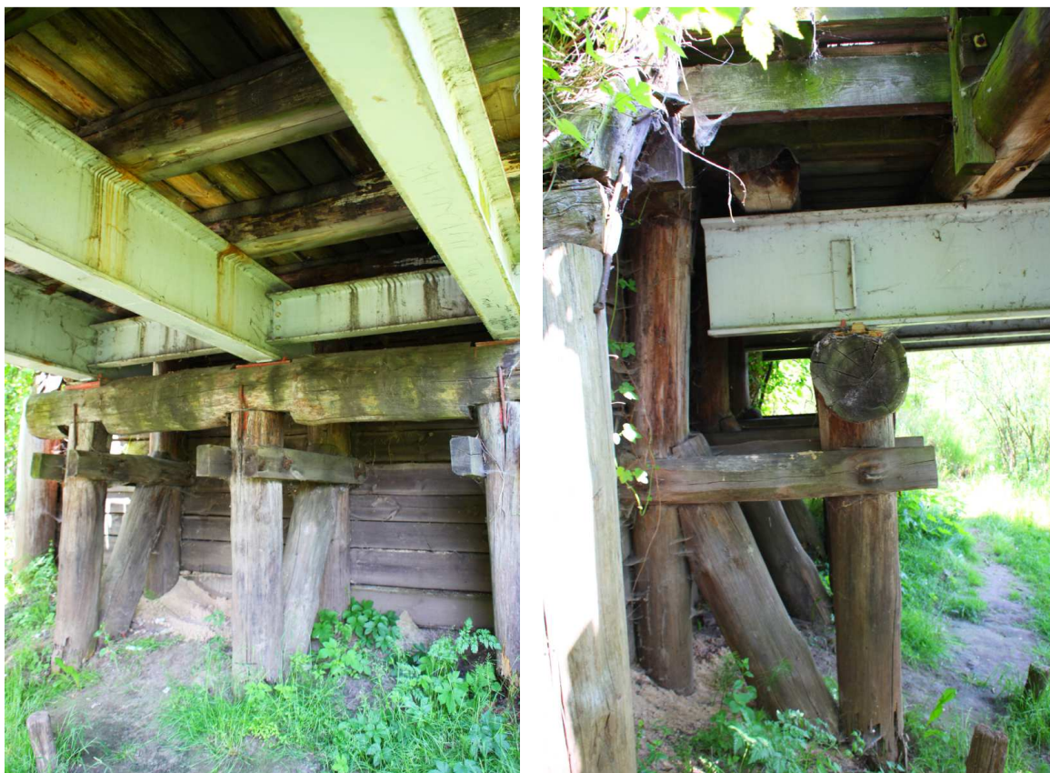
Rys. 4.1. Widok ogólny na przyczółek od strony m. Krzętów; widoczna degradacja konstrukcyjna
