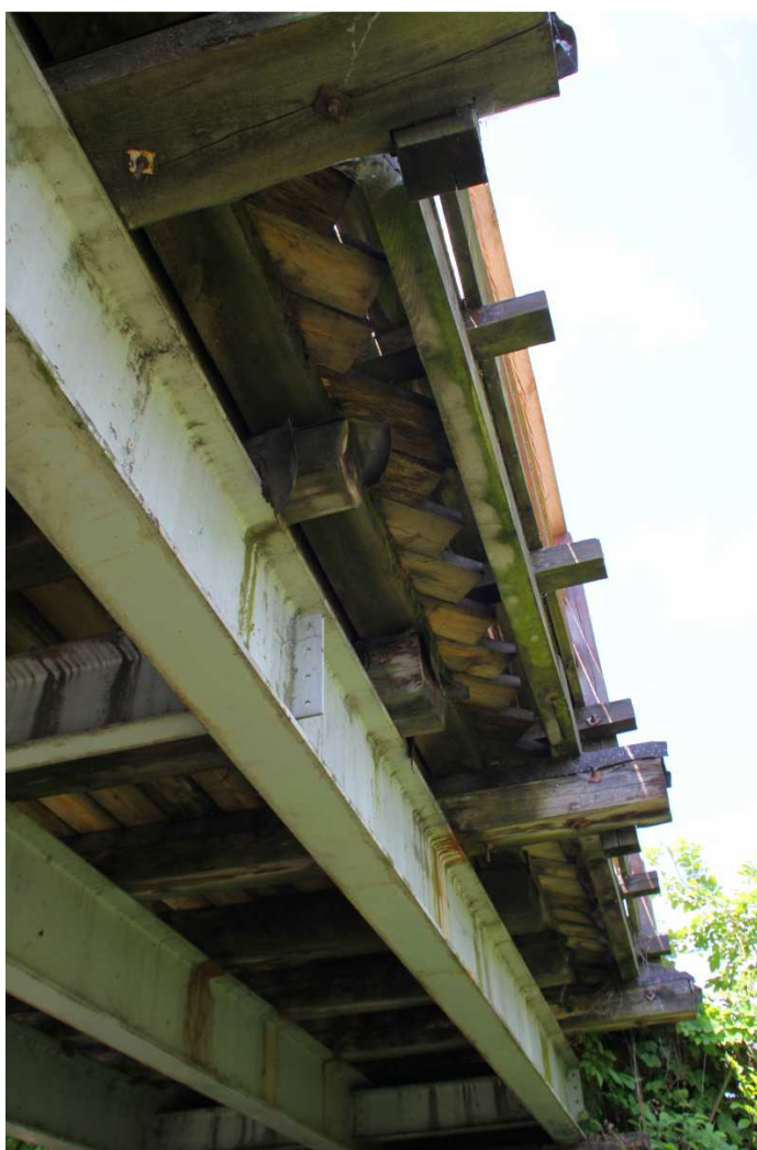
Rys. 4.5. Korozja biologiczna pokładu drewnianego
